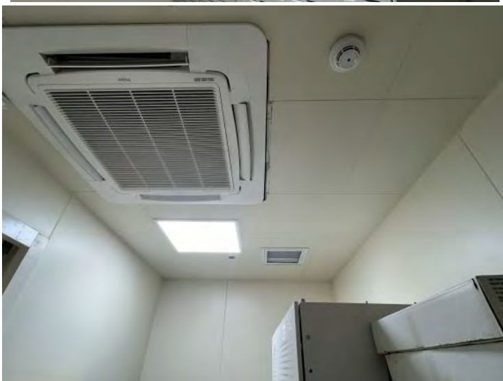
机房内通风系统
